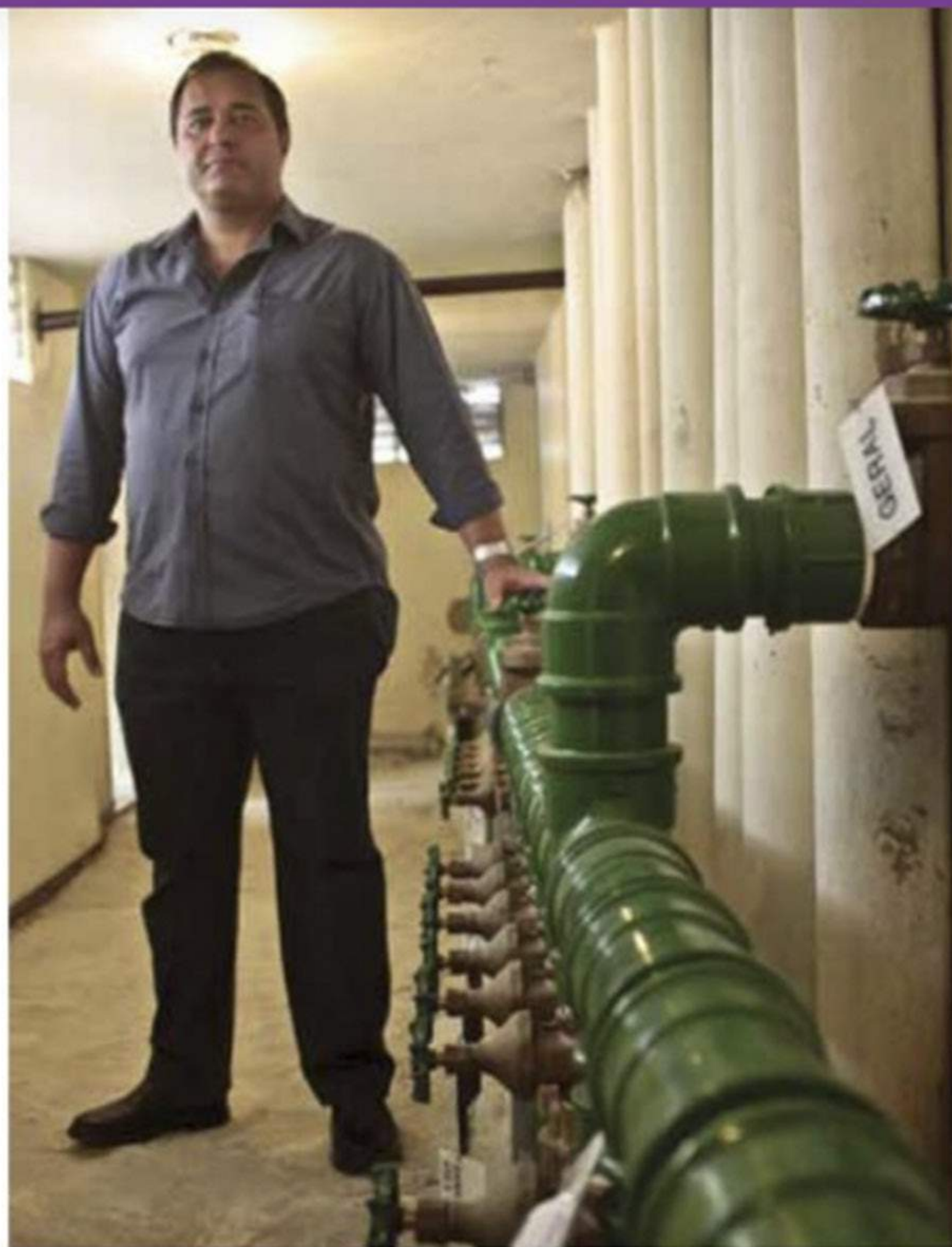
O SÍNDICO MARCELO VALENTE ENCONTROU NO GEOSTANK UMA SOLUÇÃO SUSTENTÁVEL PARA O CONDOMÍNIO VIAREGGIO
